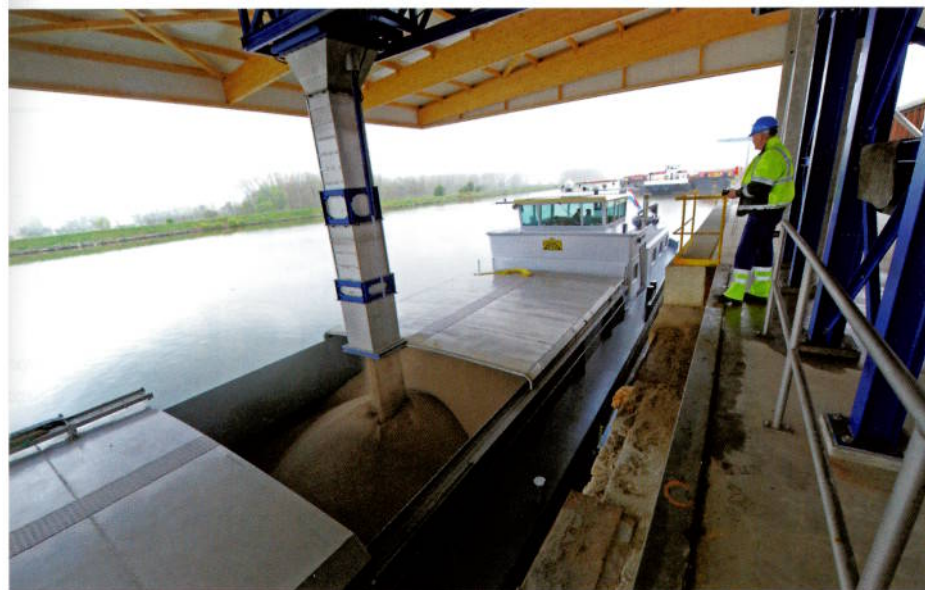
Afb. 4 Onder de overkapping bevindt zich de beweegbare beladingsband, waarmee schepen over de gehele breedte kunnen worden beladen
